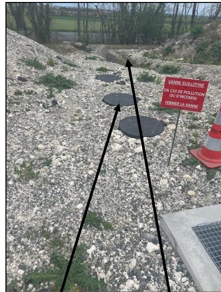
Séparateur à hydrocarbure.
