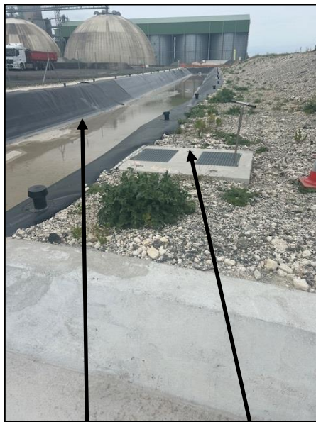
Bassin de confinement étanche.
